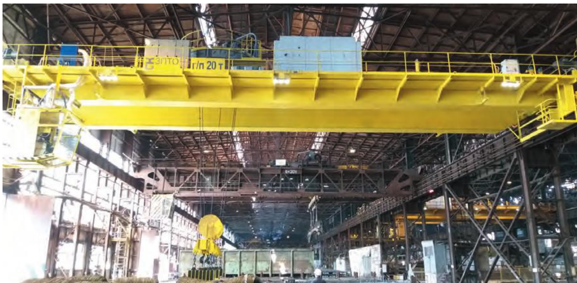
Кран мостовой г/п 20 т, установленный на складе готовой продукции СПЦ№ 1
