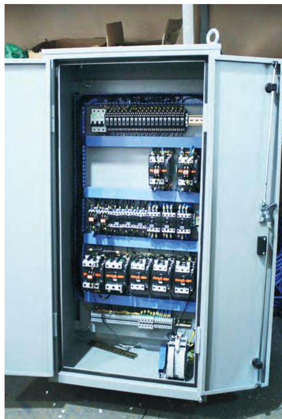
Панель сопряжения производства ООО «МОНТАЖКРАНСЕРВИС»
